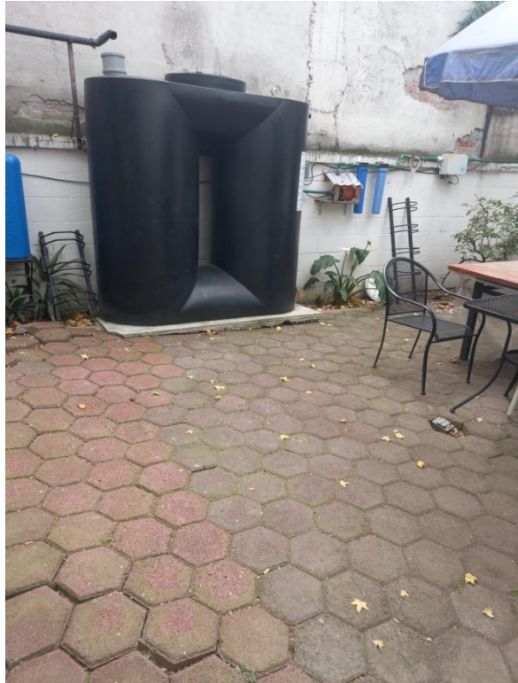
Sistema colector y de almacenamiento
